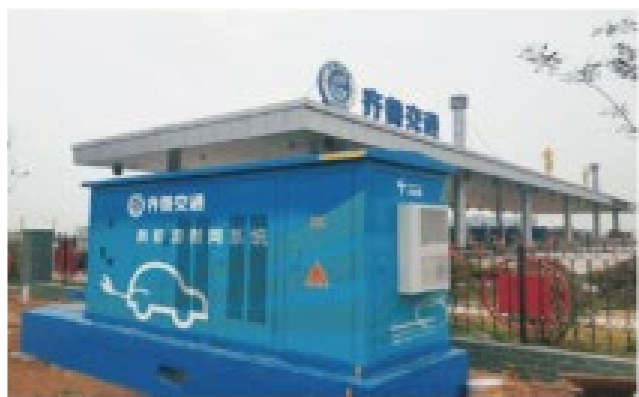
■ 齐鲁交通微电网项目
