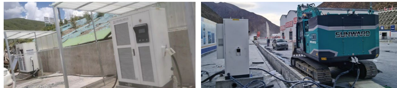
■ 新能源宽体自卸车充电桩项目
