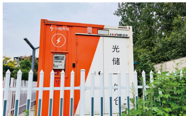
■ 杭州小桔光储存项目
