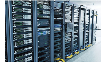
■ 智能微电网技术研究实验室
