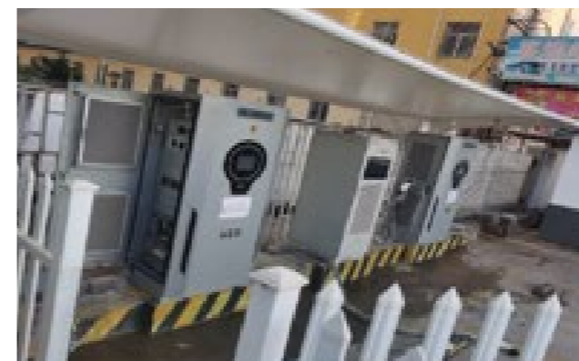
■ 云南电网玉溪综合能源站项目
