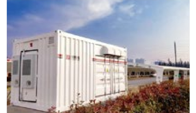
■ 西电光储充放直流微网项目
